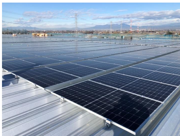
太陽光パネル
